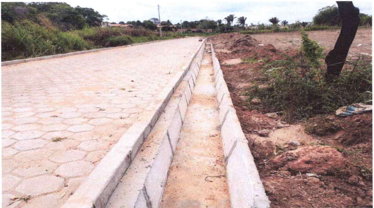
Valetas de proteção para escoamento de águas pluviais
