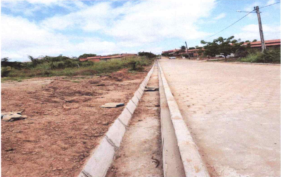
Valetas de proteção para escoamento de águas pluviais
